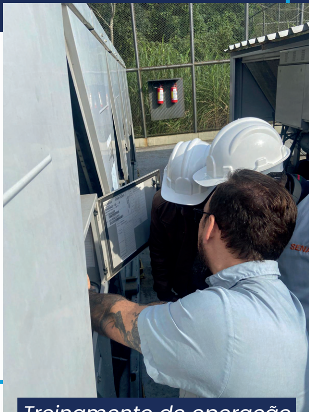
Treinamento de operação de chiller Carrier
